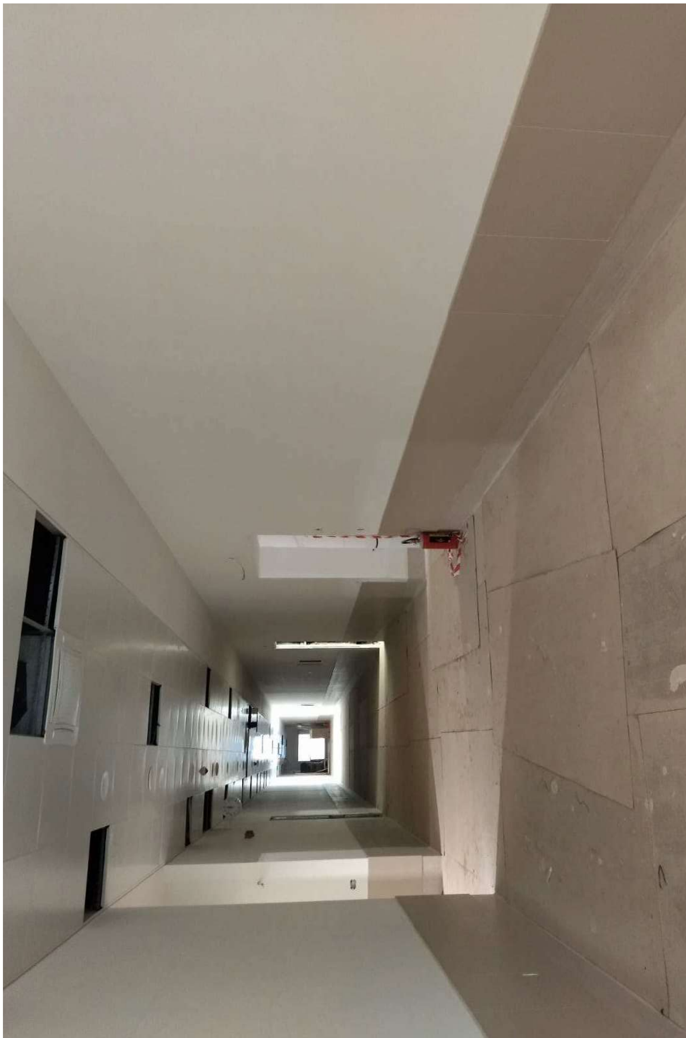
Foto F - spazio di attesa - installazione opera d'arte n. 3 e 4
